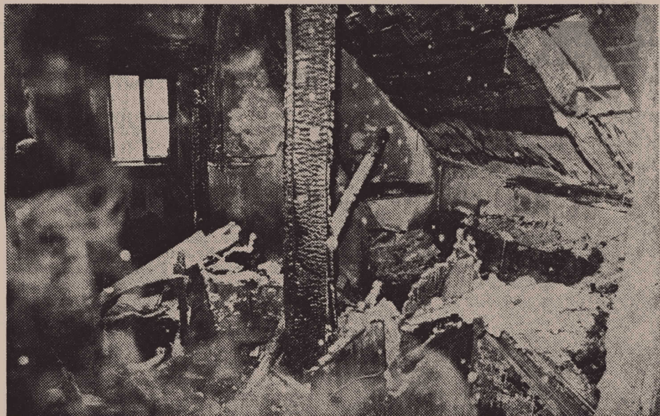
VOLLKOMMEN ausgebrannt ist die Wohnung im Dachstuhl.
